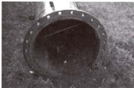
2. Dépôts colmatants dans le gaz CK
