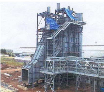
▲ Figure 1 : Vue de l'installation
